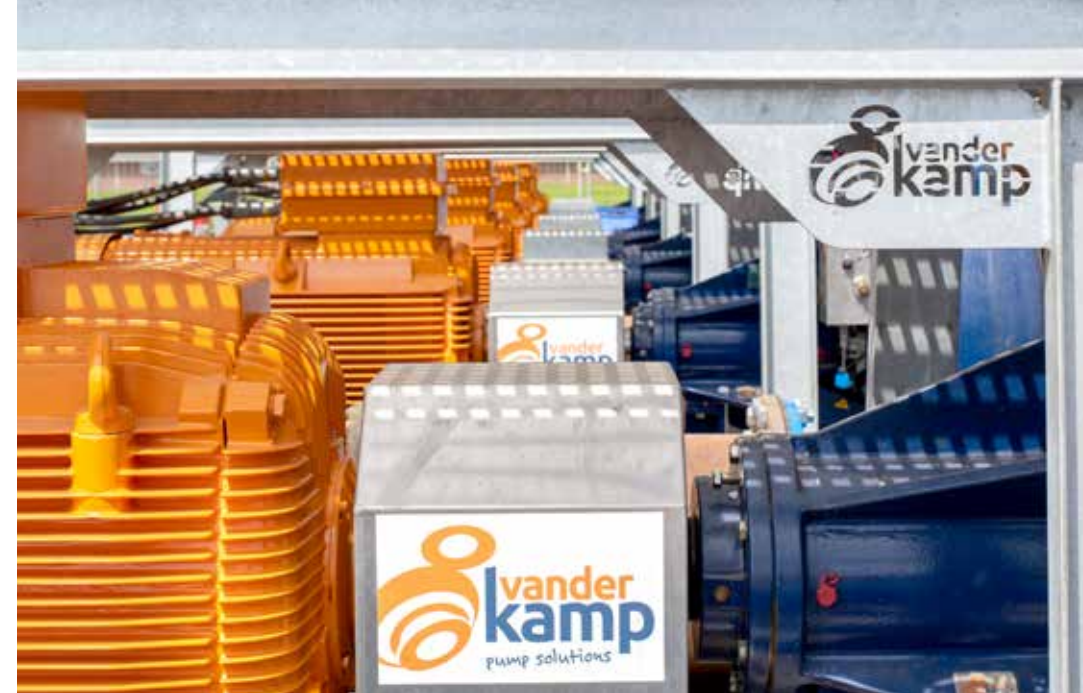
De motoren van de RWA pompen, 6x 200 kW geïnstalleerd vermogen.
